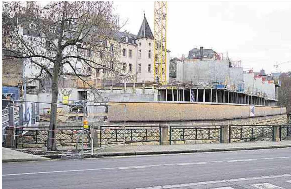
Im kommenden Jahr investiert die Stadt Luxemburg insgesamt 28,1 Millionen Euro in Schulen. Auf dem Bild sieht man die Baustelle der Zentralschule in Clausen.
